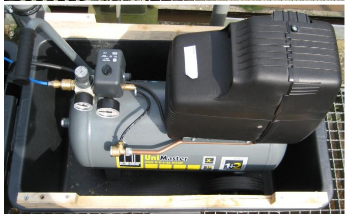
Abbildung 5: Wasserdichter Aufbau der Messelektronik der Partikelmesssonde im Ablauf der KA Rospe
