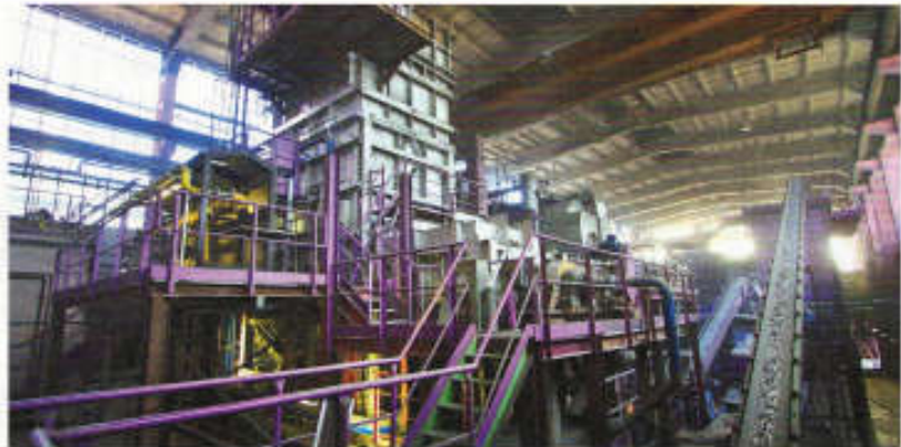
Die Vergasungsanlage Pyradec von Pyral in Freiberg.
